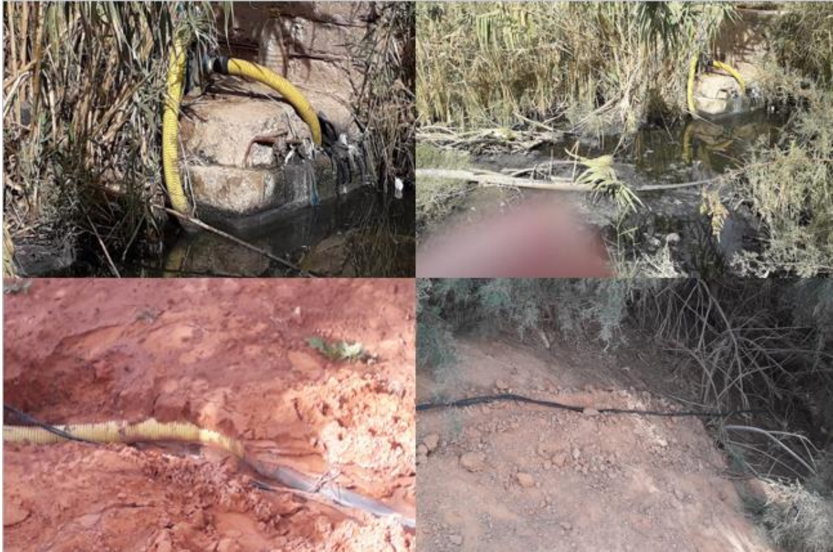
Figure 13 : photos illustrant le pompage illicite des eaux usées brutes à partir du collecteur pour l'irrigation dans la région de Guerrara
