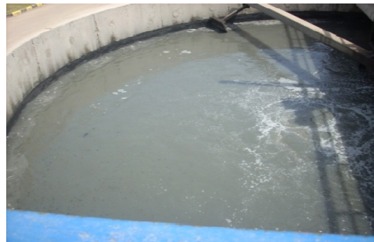
Figure 26 : Représentation du Dégraisseur de la station d'épuration de Boumerdes, Mai 2010.
