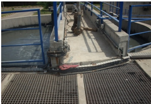
Figure 25 : Représentation du Dessableur de la station d'épuration de Boumerdes, Mai 2010.
