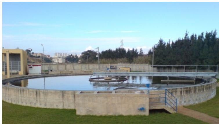
Figure 29: Représentation du Décanteur secondaire – clarificateur de la station d'épuration de Boumerdes, Mai 2010.
