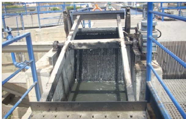
Figure 24 : Représentation du dégrilleur de la station d'épuration de Boumerdes, Mai 2010.
