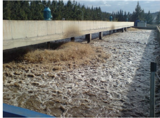
Figure 28: Représentation de l'Aération dans un bassin biologique de la station d'épuration de Boumerdes, Mai 2010.
