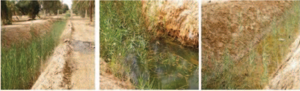
Photo 3-3. Exemples illustrant l'état du réseau de drainage
