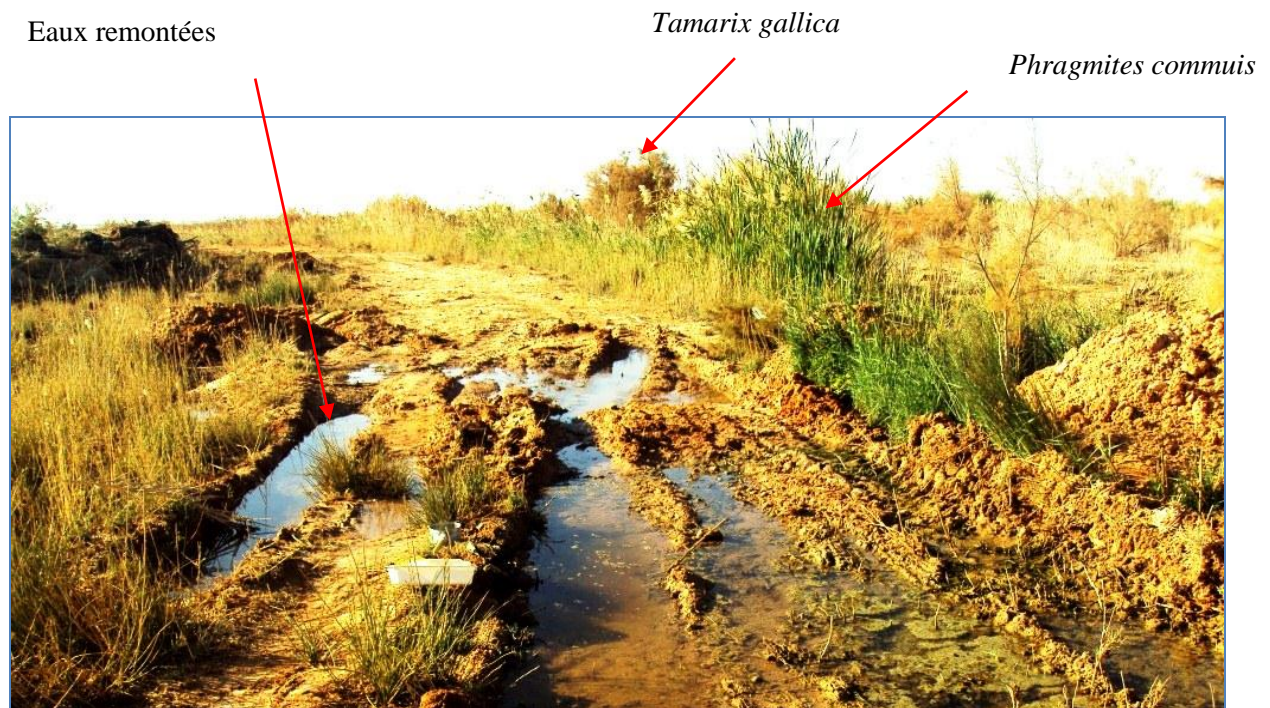
Fig. 21 – Remontée de la nappe phréatique dans la nouvelle palmeraie de Zelfana (Originale)
