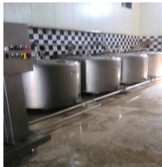
Photo 8. Les cuves de refroidissement du lait
