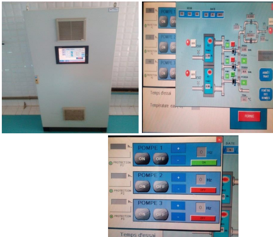
Figure 14: Sélection et réglage de la pompe à partir de l'automate du banc d'essais aspersion.
