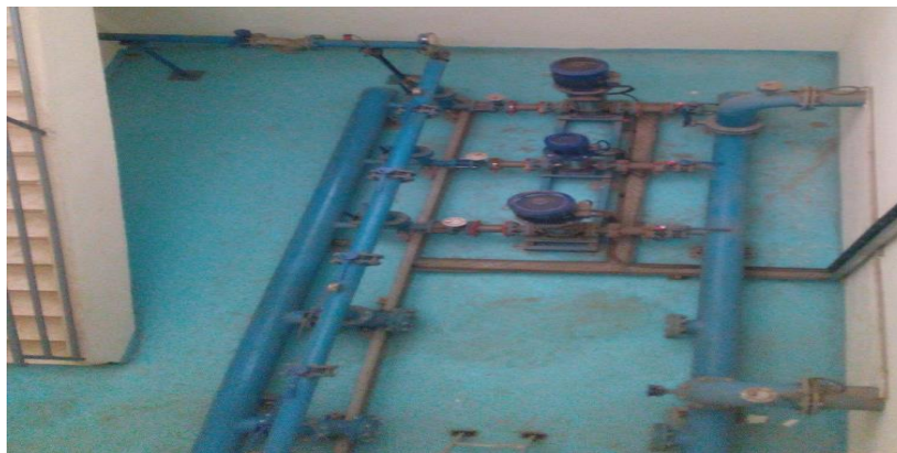
Figure 15: Station de pompage du laboratoire.
