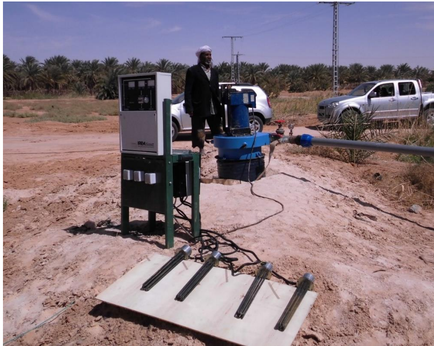
Figure 42 : La microcentrale hydroélectrique après raccordement à la tête du forage 2 – Hassi Benabdallah
