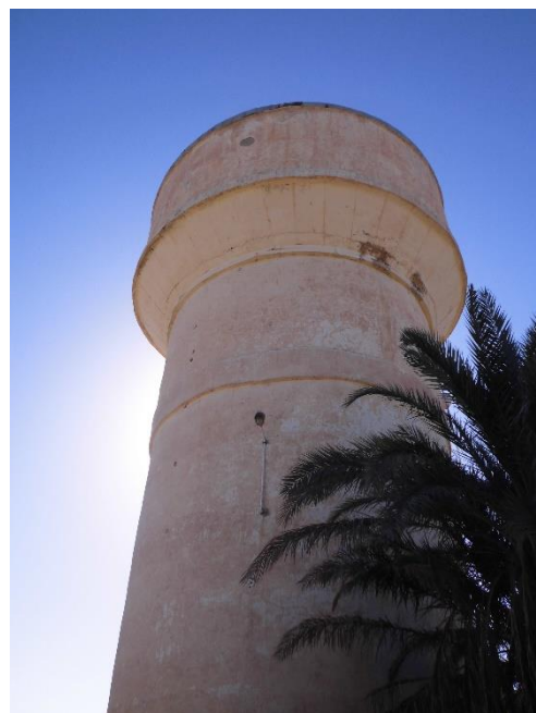
B- Château d'eau de stockage et d'exploitation du forage
