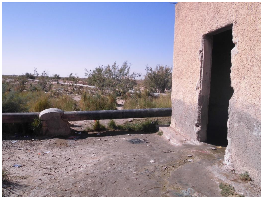
Figure 46 : La canalisation ciblée pour faire le test de la commune de Oumache - Wilaya de Biskra
