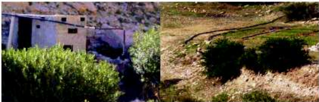
Photos 32 ; 33 : Pompe refoulant depuis la retenue collinaire (gauche) par l'intermédiaire de conduites en polyéthylène (droite)
