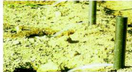
Système transirrigation enterré
