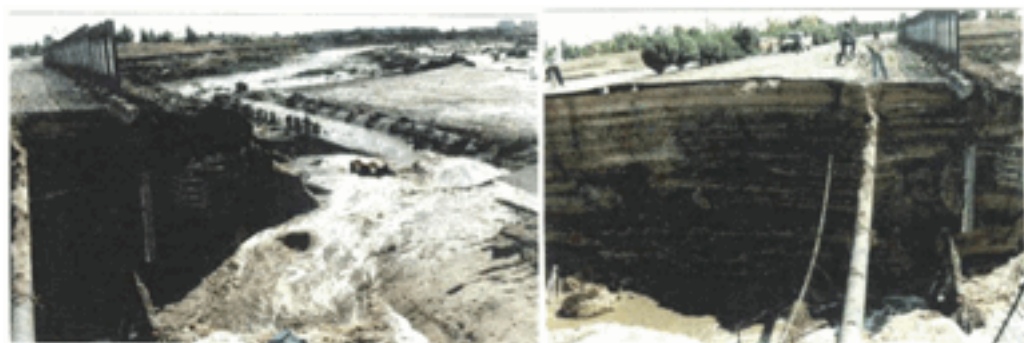
Figure 2: Glissement de terrain suite aux inondations d'Octobre 1994
