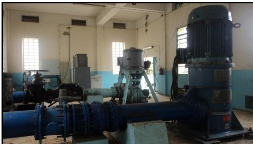
Figure 36 : Station de pompage Rhéghaia
