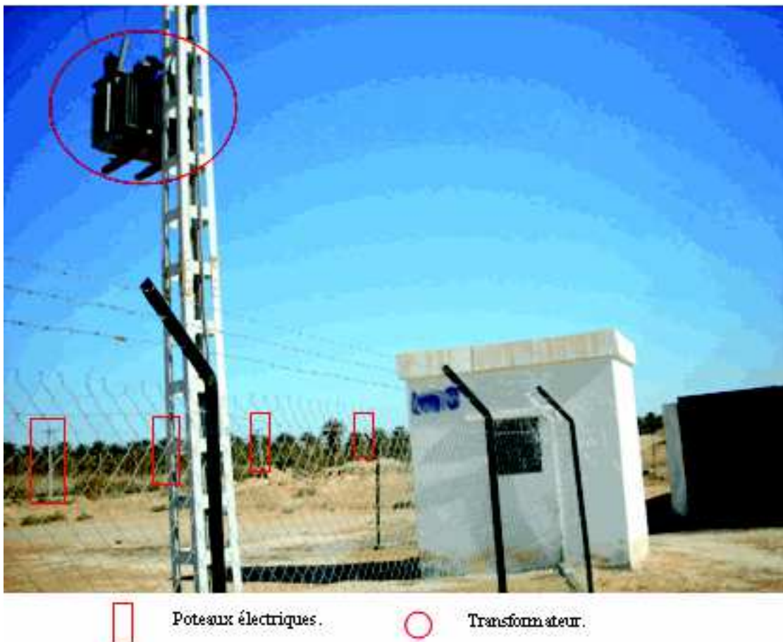
Photo 11 : Installation électrique du forage de Zaouiet Riab.
