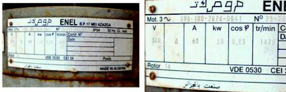
Moteur de l'extracteur de la tour de refroidissement de Zaouiet Riab
