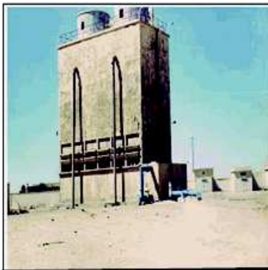
A : Refroidisseur à ventilation naturelle
