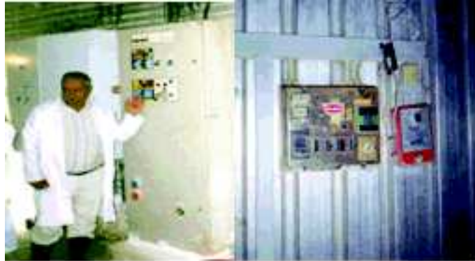
Photo 13 : Armoires de commande des chaînes d'alimentation et d'abreuvement et extincteur et compteur
