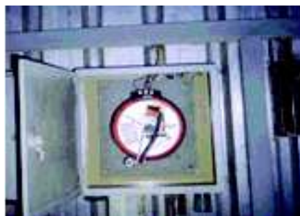
Photo 12a : Compteur potentiomètre (intensité lumineuse)
