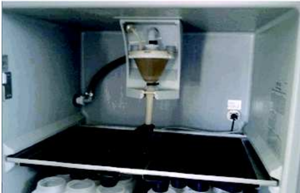
Figure 1: Vue d'intérieur d'une armoire d'échantillonnage dans la STEP de Baraki.
