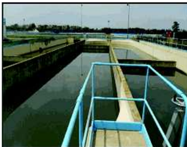
Figure VI.12 : Evacuation de l'eau épurée de la STEP Baraki, année 2011
