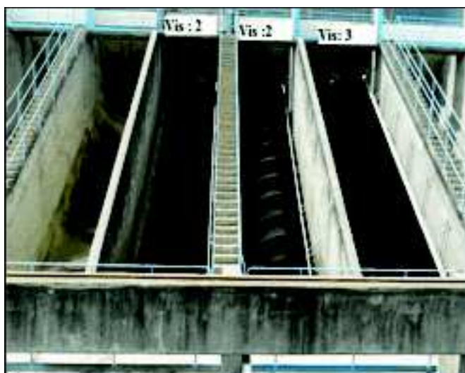
Figure VI.3 : Poste de relevage PR2 de la STEP Baraki, année 2011
