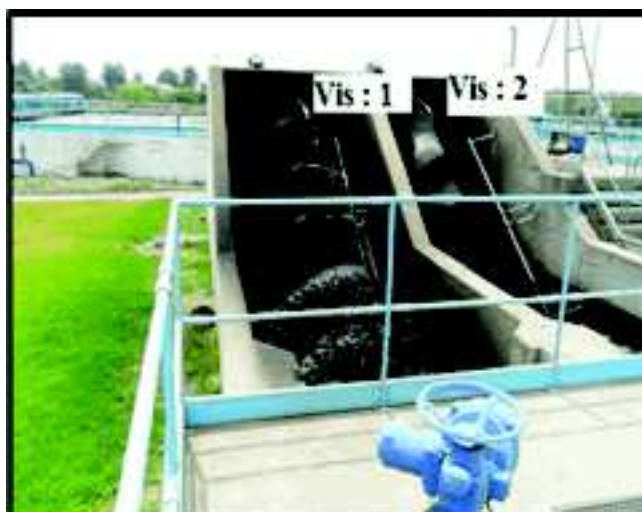
Figure VI.13: Vis recirculation des boues de la STEP Baraki, année 2011
