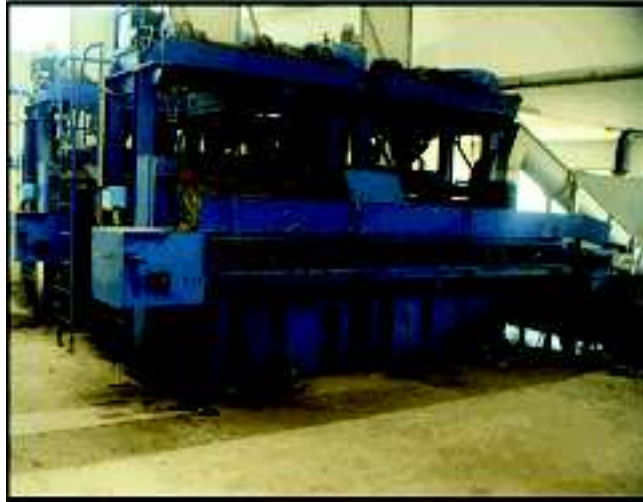
Figure VI.4 : Dégrilleur mécanique fin et grossier de la STEP Baraki, année 2011
