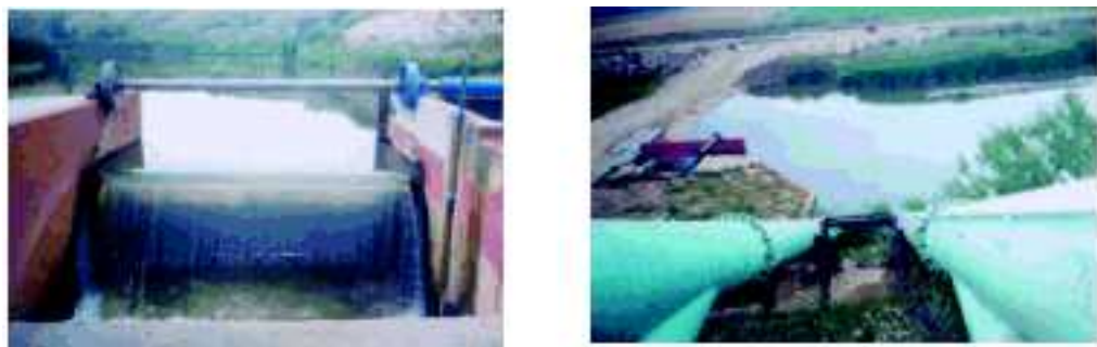
Photos 3 : Seuil de prised'eau à gauche et pompes d'exhaure à droite
