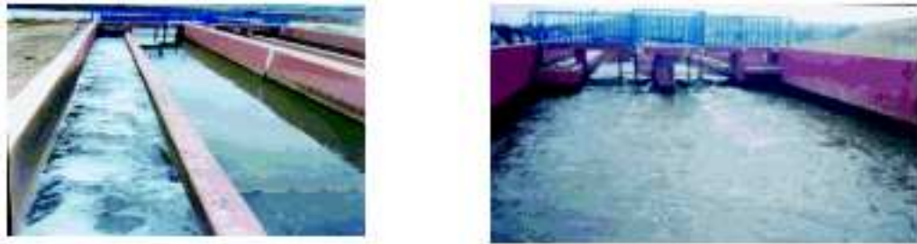
Photos 4 : Dessableur et bache de reprise de la station de refoulement (I)
